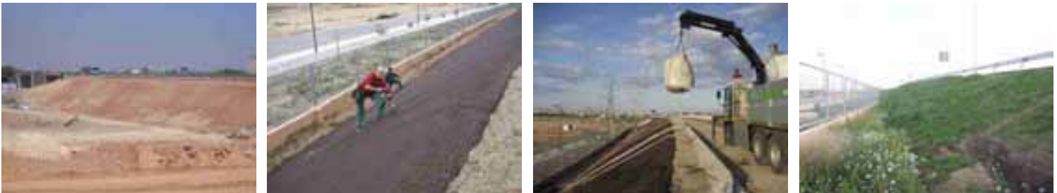
Instalación de TRINTER - Z.A.L, Valencia.
